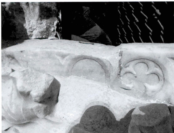
FIGURA 6: Dintel del arcosolio y acceso al espacio de las reliquias desgastado. Foto: E. Zahonero, J. Mendiola
